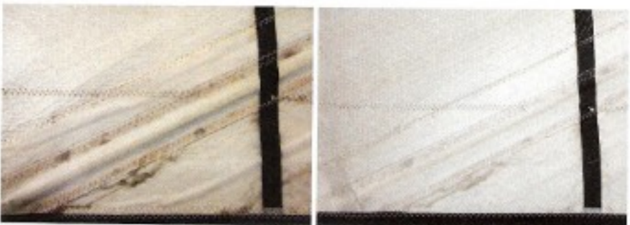
An der Lattentasche gelangten Nässe und Dreck unter die äußere Schutzlage Diese tiefer liegenden Flecken konnten nicht beseitigt werden
